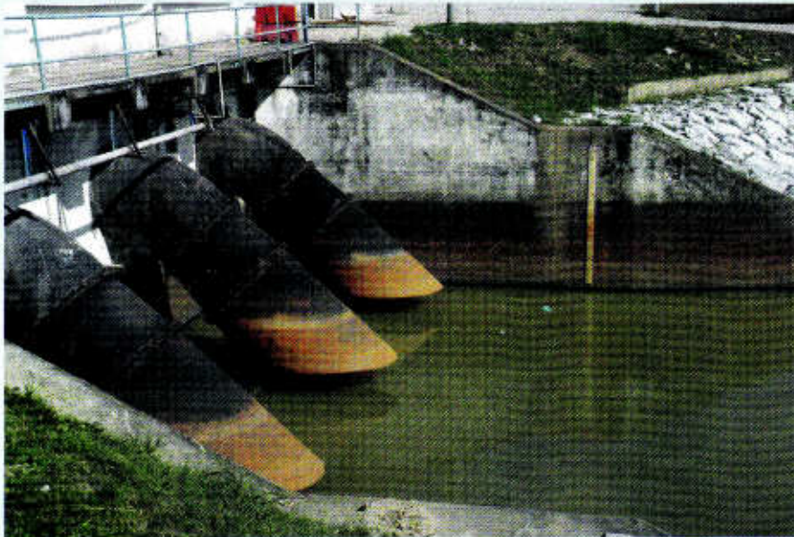
Intake rumah pam KADA tergantung akibat susutan aras air sungai.
